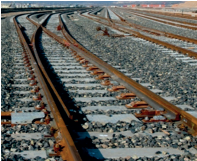
Figura 5 – Deviatoio. Figure 5 – Turnout.
