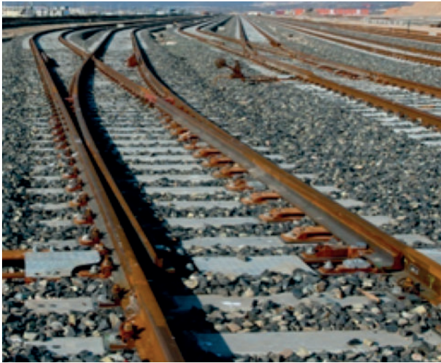
Figura 5 – Deviatoio. Figure 5 – Turnout.
