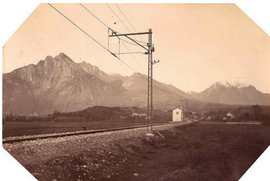
Figura 29 – Linea aerea di contatto e dispositivo di sezionamento. Figure 29 – Contact airline and sectioning device.
