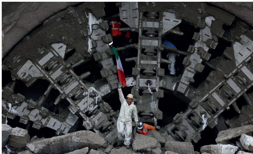
(Fonte: FS Engineering, Gruppo FSI) Figura 1 - Abbattuto l'ultimo diaframma della Galleria Rocchetta.
